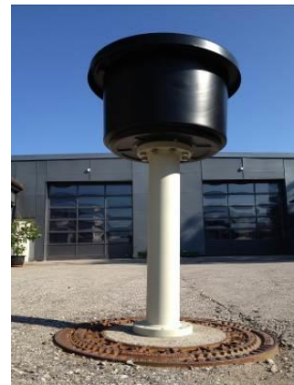
Passiv luftning av rörledning.
