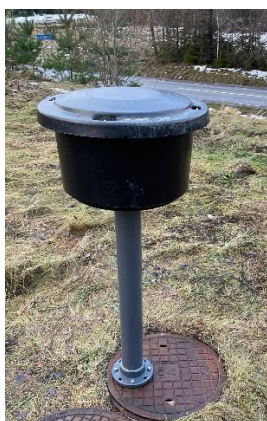
Passiv ventilation av släppbrunn i Sthlm
